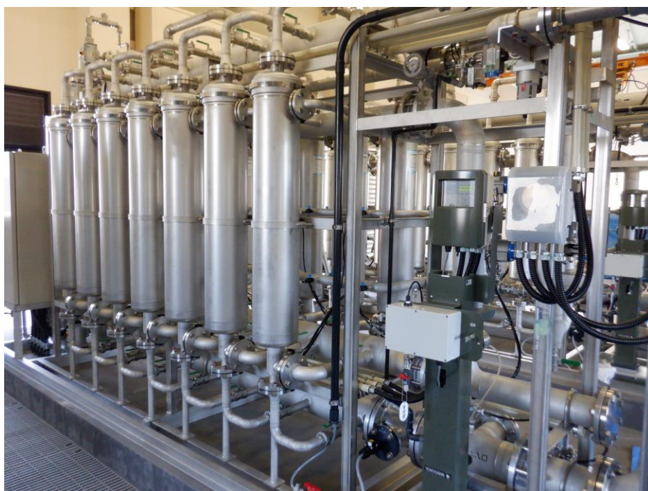
下市木・志原浄水場 膜ろ過設備
