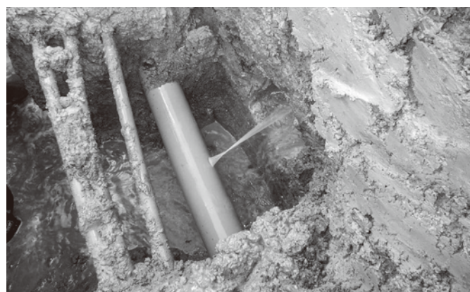
中心に穴があき、漏水している管
