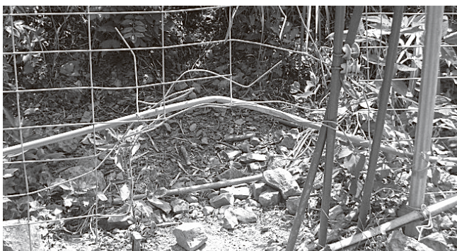
破壊された柵
