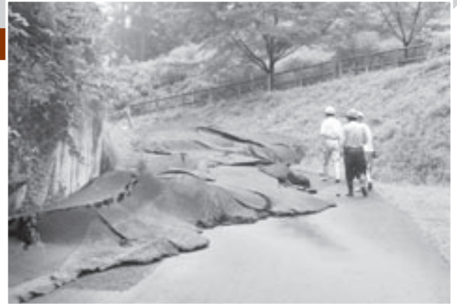
地すべりにより隆起したアスファルト
