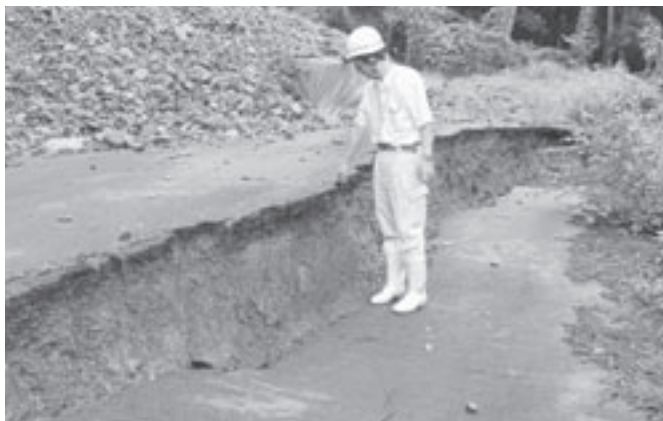
地すべりにより段差が生じる
